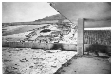
3 | Un foro passante – dei quattro totali – provocato dall'esplosione di una granata dell'artiglieria alleata sul tetto del secondo capannone del museo (Altamura, Paolucci 2023).
